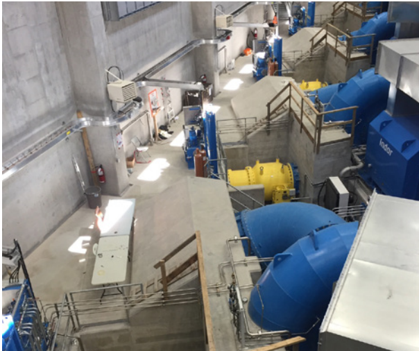
Bild 6: VAG RIKO® Ringkolbenventile DN 1000 als Turbinenbypass
